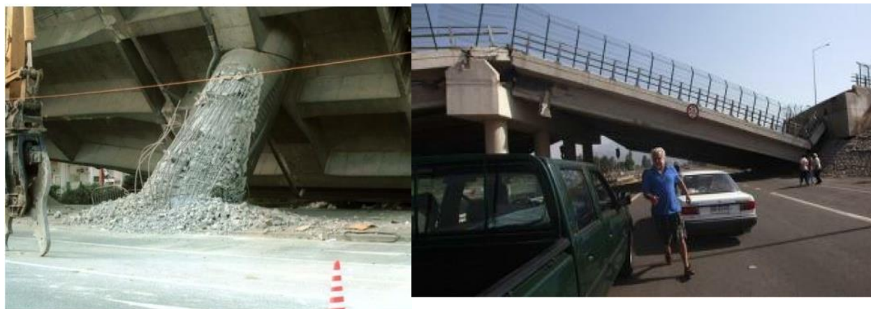
Рис.1. Разрушение насыпи перед береговой опорой
